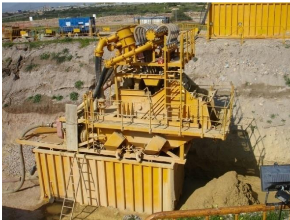
Planta de separación del material extraído
