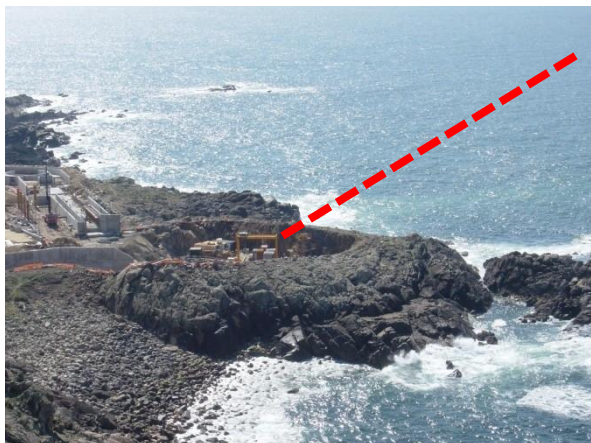
Pozo de ataje de emisario submarino. A Coruña
