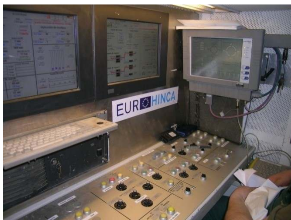
Cabina de control de tuneladora EPB
